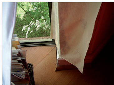
Fig. 7 Daño mayor en papel mural producto de humedad, condensación y mal mantenimiento de la propiedad.
