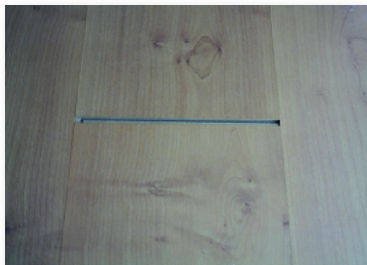
Fig. 4 Separación de tablas producto del uso, sin la debida precaución y mantención
