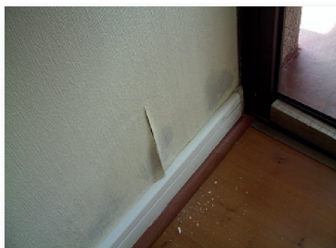
Fig. 6 Papel despegado y con hongos, producto de condensación y mala ventilación.
