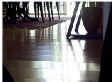
Fig. 5 Piso fotolaminado levantado en las uniones producto de la humedad.
