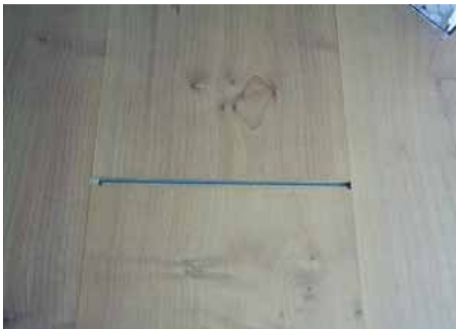
4 . Separación de tablas producto del uso, sin la debida precaución y sin la debida precaución y manutención.
