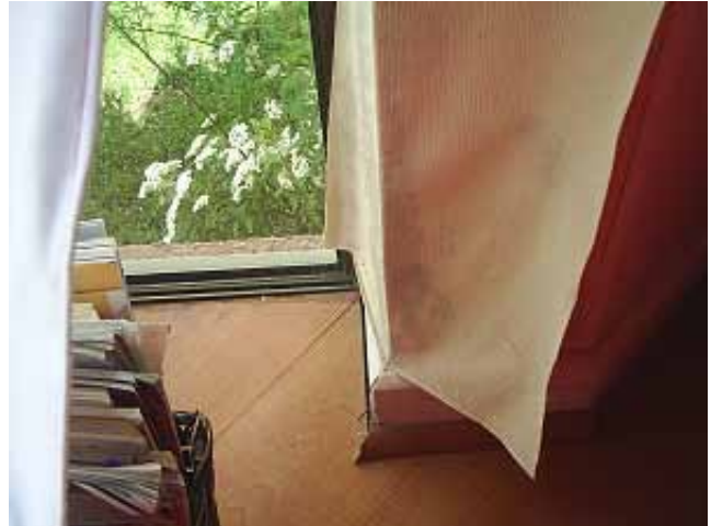
7. Daño mayor en papel mural producto de humedad, condensación y mal mantenimiento de la propiedad.
