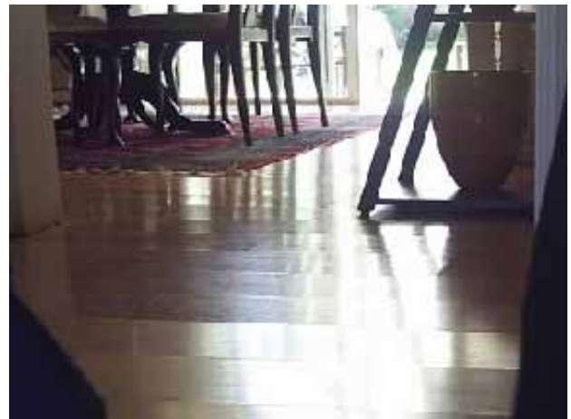
5. Piso fotolaminado levantado en las uniones producto del exceso de productos de limpieza y humedad.
